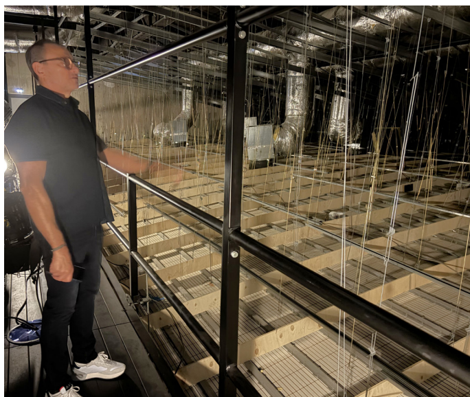
De nombreuses imperfections ont été décelées dans le dispositif qui soutient le faux-plafond. Ce qui, en attendant son remplacement, avait nécessité la pose d'un filet de protection.
